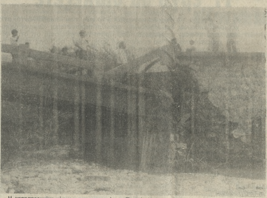
Η καταστρεμμένη γέφυρα του ποταμού της Παχιάς Άμμου, από την άγρια ορμητικότητα του νερού της πλημμύρας.
