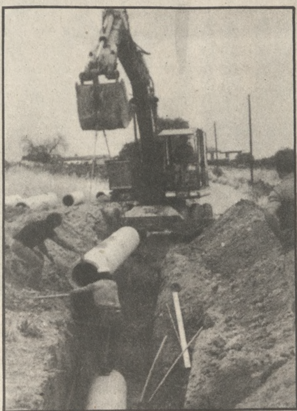
Κατασκευή του Κεντρικού αγωγού μεταφοράς νερού από τις γεωτρήσεις Τυλίσσου στο Ηράκλειο
